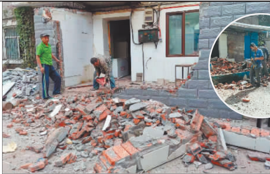
小区居民自拆违建。
